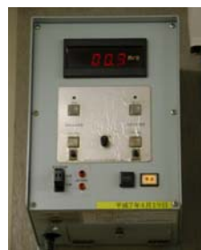
監視駅内 風速表示器
