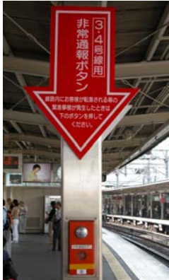
非常停止押しボタン
