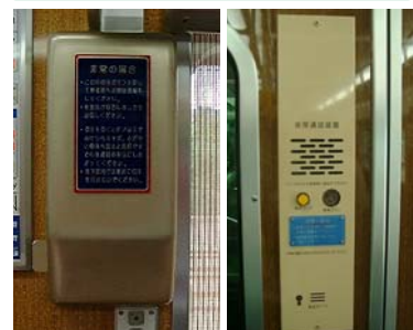
非常通話装置
