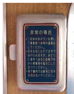
非常通報装置
