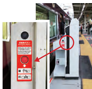
ホームドア非常用ボタン
