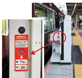
ホームドア非常用ボタン
