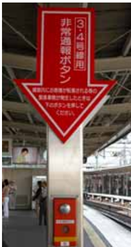
非常通報ボタン
