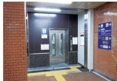
エレベーター
