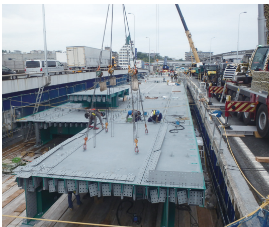
中国道リニューアル工事 (阪急交差部近傍での新しい橋桁の架設状況)
