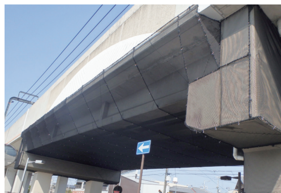
コンクリート片はく落防止用ネット設置状況
