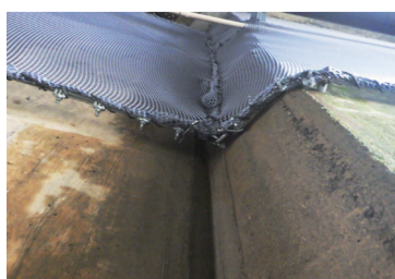
コンクリート片はく落防止用ネット
